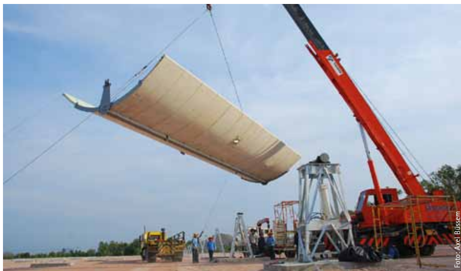
Das erste Parabolrinnen-Kraftwerk in Asien (Kanchanaburi), das auf dem Prinzip der Direktverdampfung basiert, soll Ende 2010 in Betrieb genommen werden.
